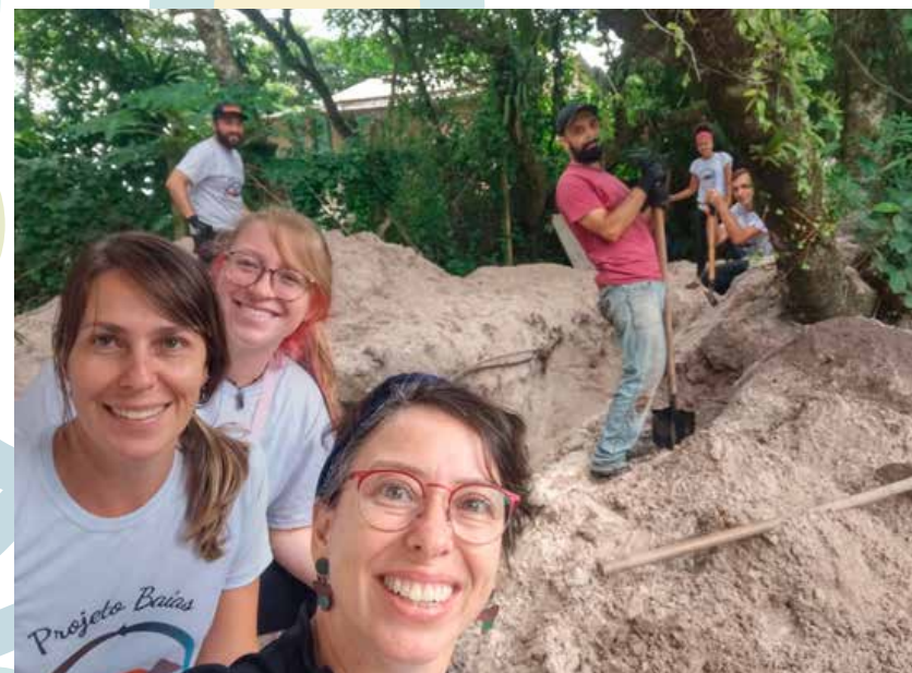
Figura 4: Equipe na construção do sistema de tratamento em Brasília (Ilha do Mel/PR)
